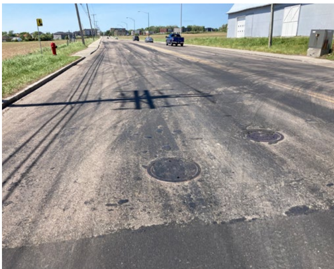
Photo 1 – Bitume transporté sur les routes en dehors du chantier (source: MTMD).
