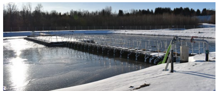
Étang aéré : technologie KAMAK de Bionest
