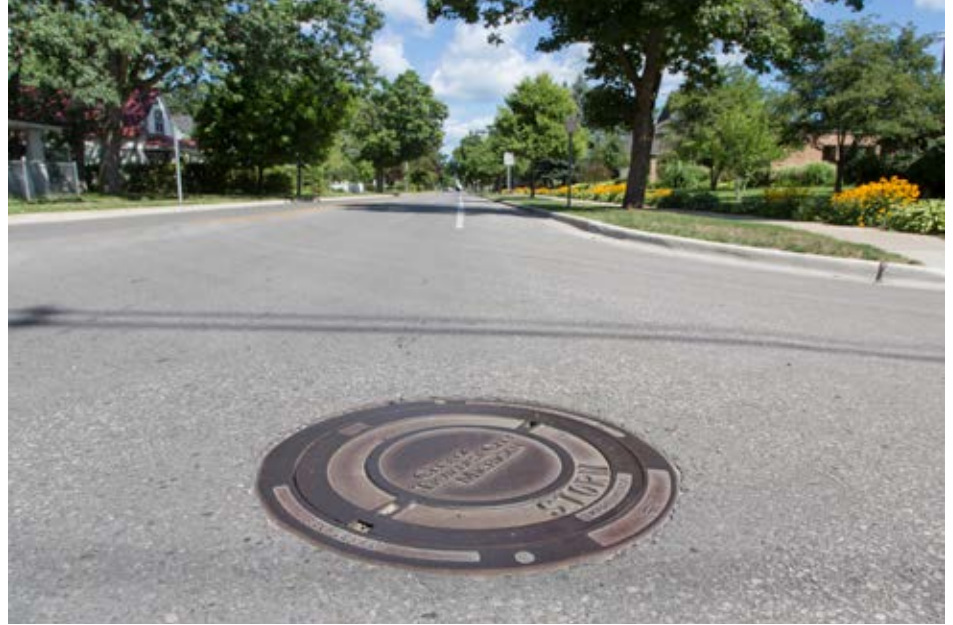
Ensemble SELFLEVEL installé à Traverse City, Michigan.
