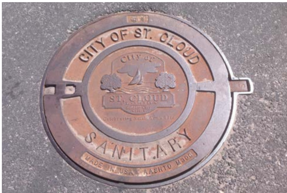
Ensemble d'accès ERGO dans la ville de St. Cloud, Floride.
